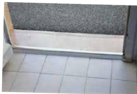
Accessibilité du local communal loué au kinésithérapeute au complexe sportif (mise en place d'un seuil franchissable par un chariot)
