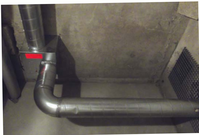
Une ventilation performante a été installée à la salle polyvalente afin de régénérer plus rapidement l'air de la cuisine et des toilettes. Cet équipement permettra de lutter plus efficacement contre l'humidité et évacuera la condensation due à l'utilisation du nouveau lave-vaisselle.
