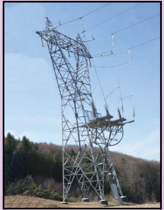
Pylône aérosouterrain à La Cotête
