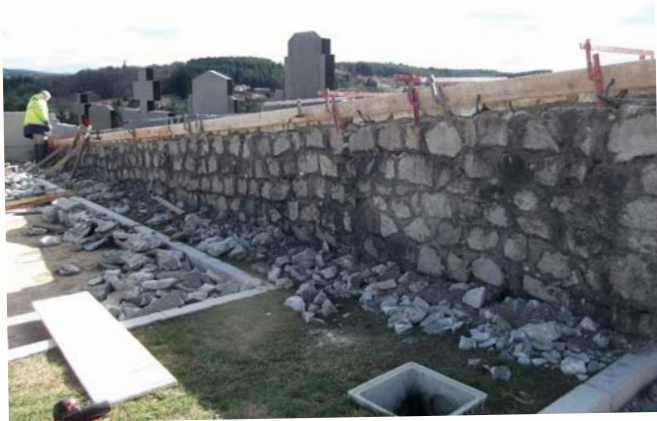
Une partie importante du mur d'enceinte de l'ancien cimetière a été rénovée ; couvertines et jointement de pierres ont été effectués afin de lutter contre les infiltrations d'eau.
